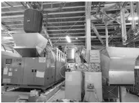
クロスの洗濯ライン
